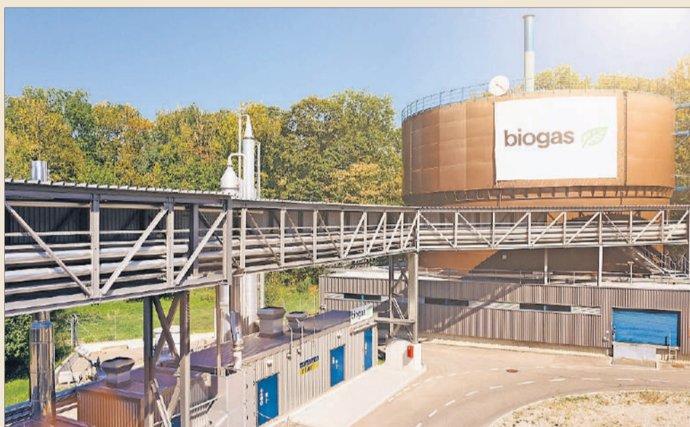
Bioabfälle und Grüngut aus Zürich werden im Werdhölzli zu wertvollem Biogas.
