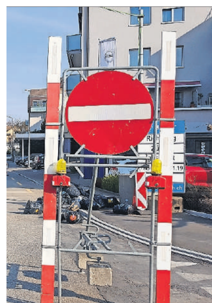
Falsche Richtung: Um die Baustelle gilt Einbahnverkehr.
