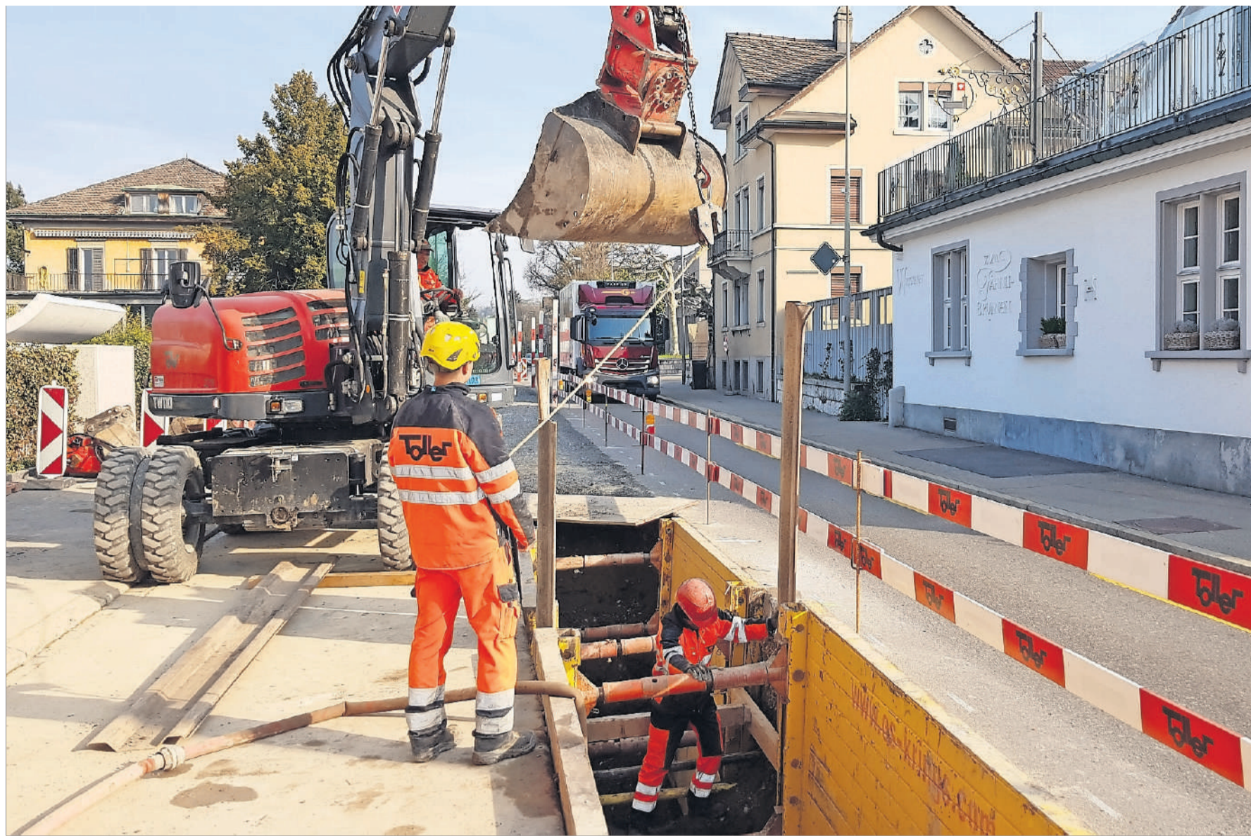
Zwischenziel Kusenbach: Abschnitt um Abschnitt wird der Graben geöffnet, die Kanalisation verlegt und mit Kies zugedeckt.
