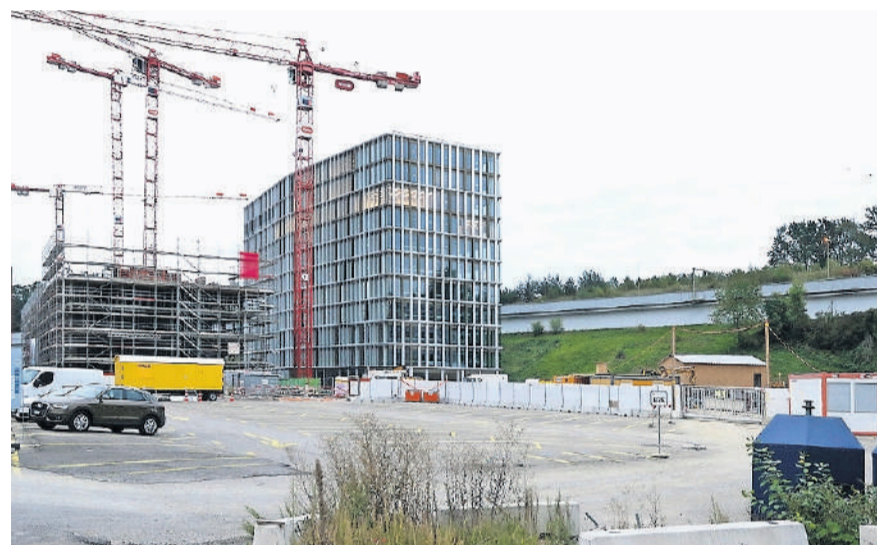
Auch Greencity ist noch nicht fertig gebaut: Auf dem Platz vor dem künftigen Hotel (l.) und dem Bürohaus entsteht bis 2023 die Schule Allmend.
