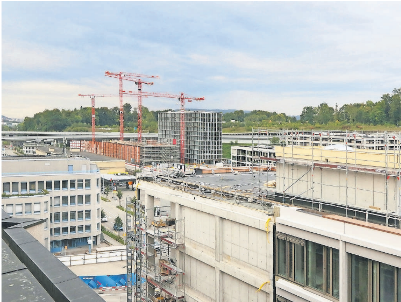
Wo die Kräne stehen, wird gerade das künftige «Geschäftsviertel» von Greencity gebaut.
