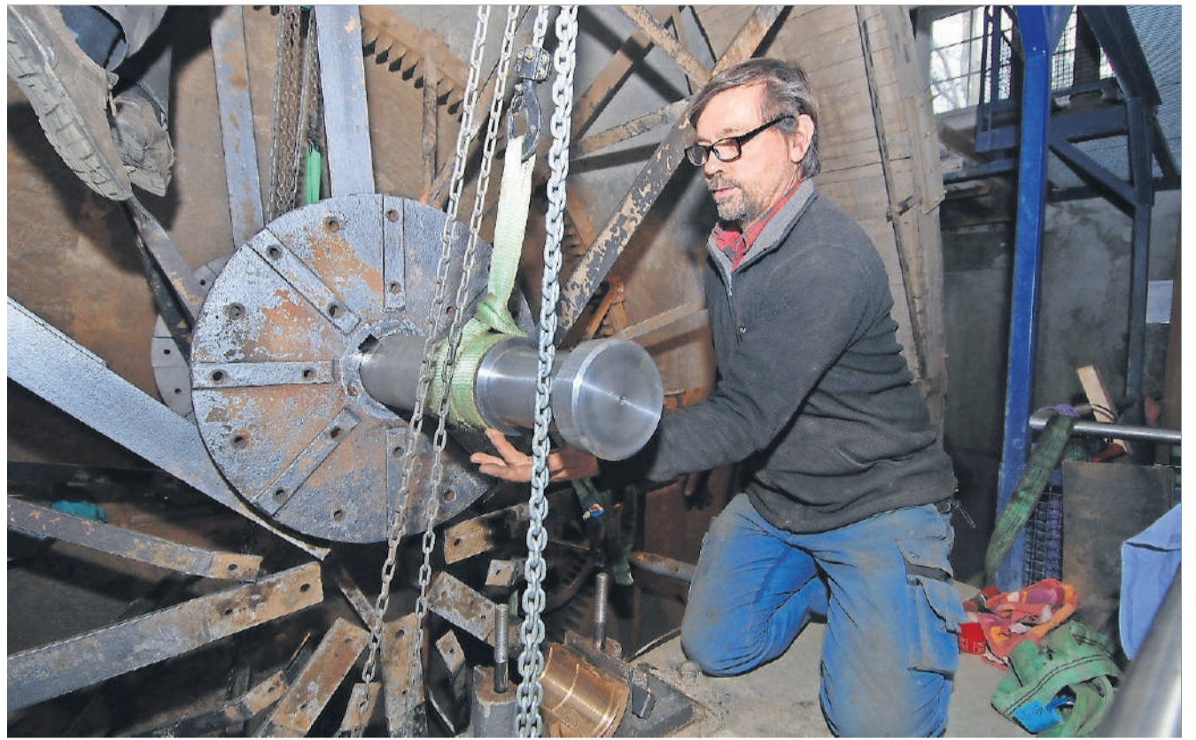
Die Hauptarbeit ist getan: Kurt Fasnacht hat in das Mühlrad eine neue Welle eingesetzt. Foto: Thomas Hoffmann
